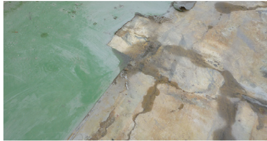
防水層内の湿気によって躯体表面が劣化している状況
